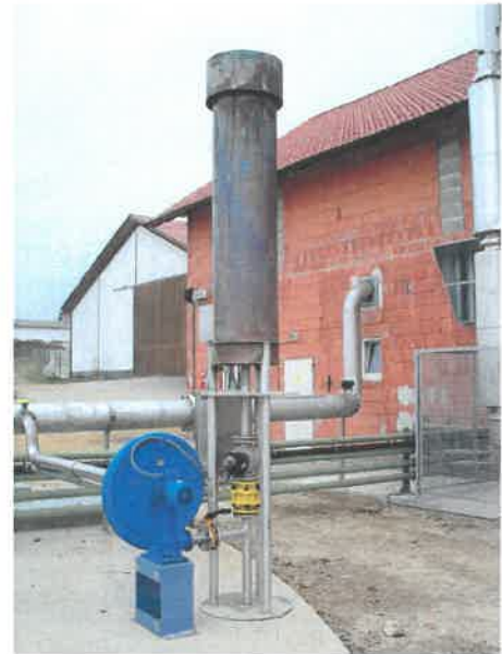
Torchère et son dispositif de ventilation. Source : Biogas Hochreiter GmbH - A.E.B. - Méthafrance.
